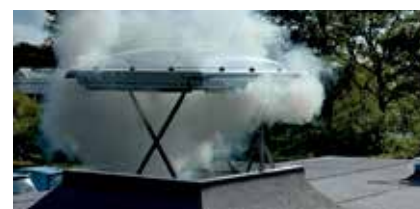
Okno oddymiające CSP
